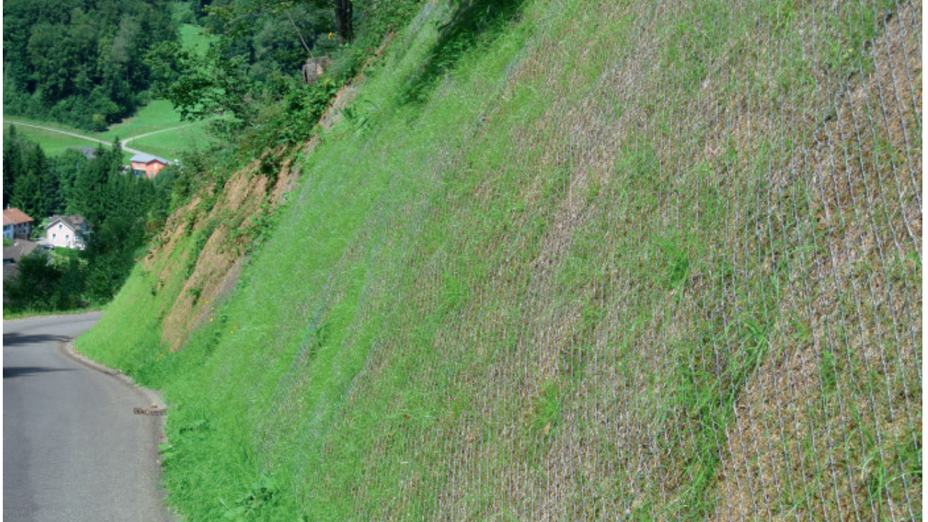
Jährlich entstehen in und um den Siedlungsraum neu zu begrünende Flächen, darunter auch viele Böschungen. Die fachlich korrekte Begrünung ist zentral, um einsetzender Erosion vorzubeugen. Im Bild eine Abdeckung mit Holzwollevlies und zusätzlichem Diagonalgeflecht aus Metall
