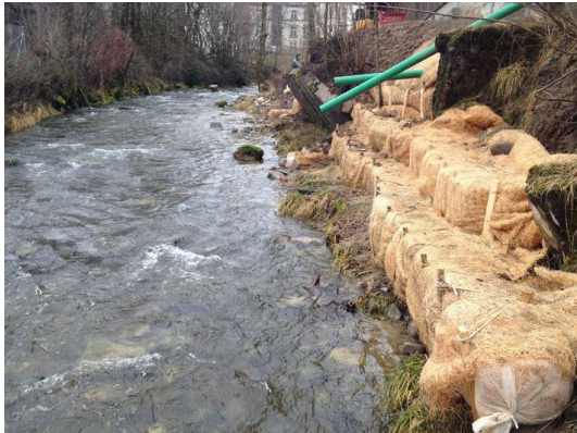
Figura 01_ Fascine Howolis Q: protezione delle sponde artificiali con fascine Howolis Q (i tubi verdi sono una soluzione provvisoria per il flusso d'acqua, ad es. piovana)
