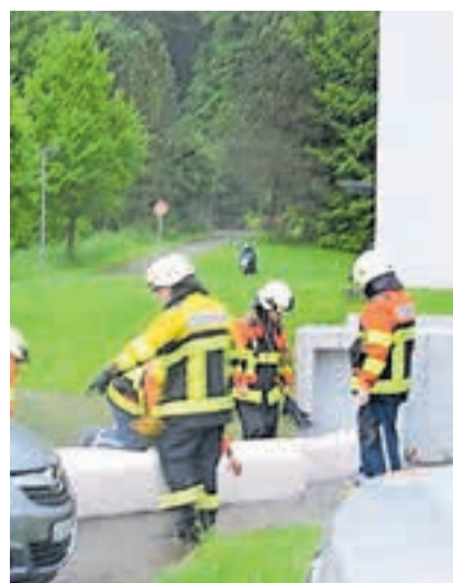
Die Feuerwehr Wattwil/Lichtensteig setzt Holzwollefaschinen zum Schutz vor Hochwasser ein. Bild: PD
