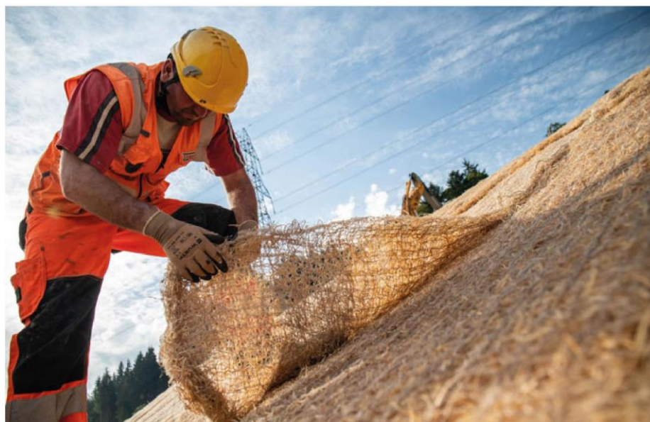
Pose d'un tapis de laine de bois pour protéger contre l'érosion (Photo: Thomas Rickenmann).
