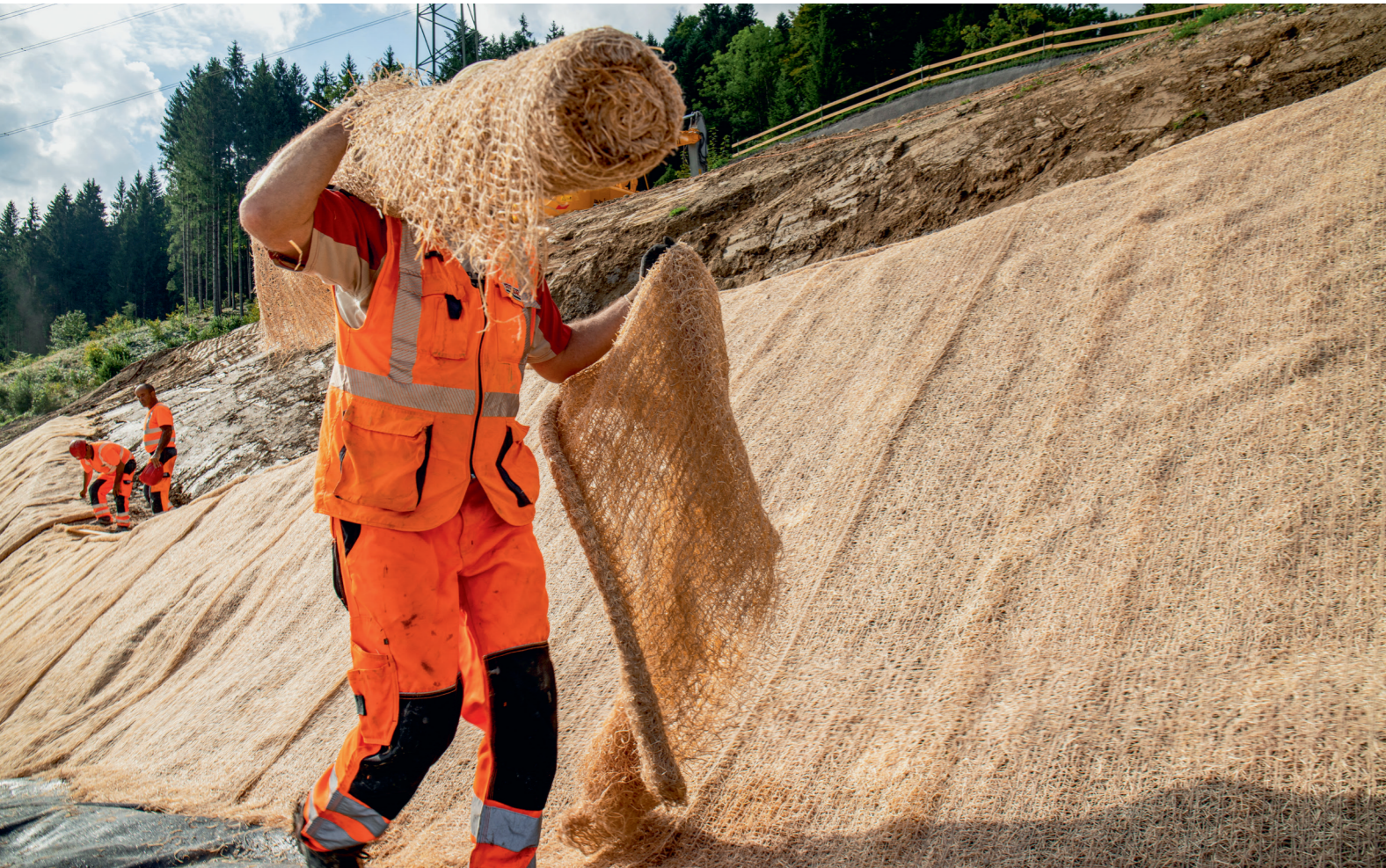
Das Risiko für Hangrutschungen ist besonders an neu erstellten Böschungen gross. Den besten Schutz gegen die Bodenerosion bildet eine stabile Vegetation mit einem starken Wurzelwerk. Zur Unterstützung werden Netze aufgelegt. Bild: Lindner Suisse
