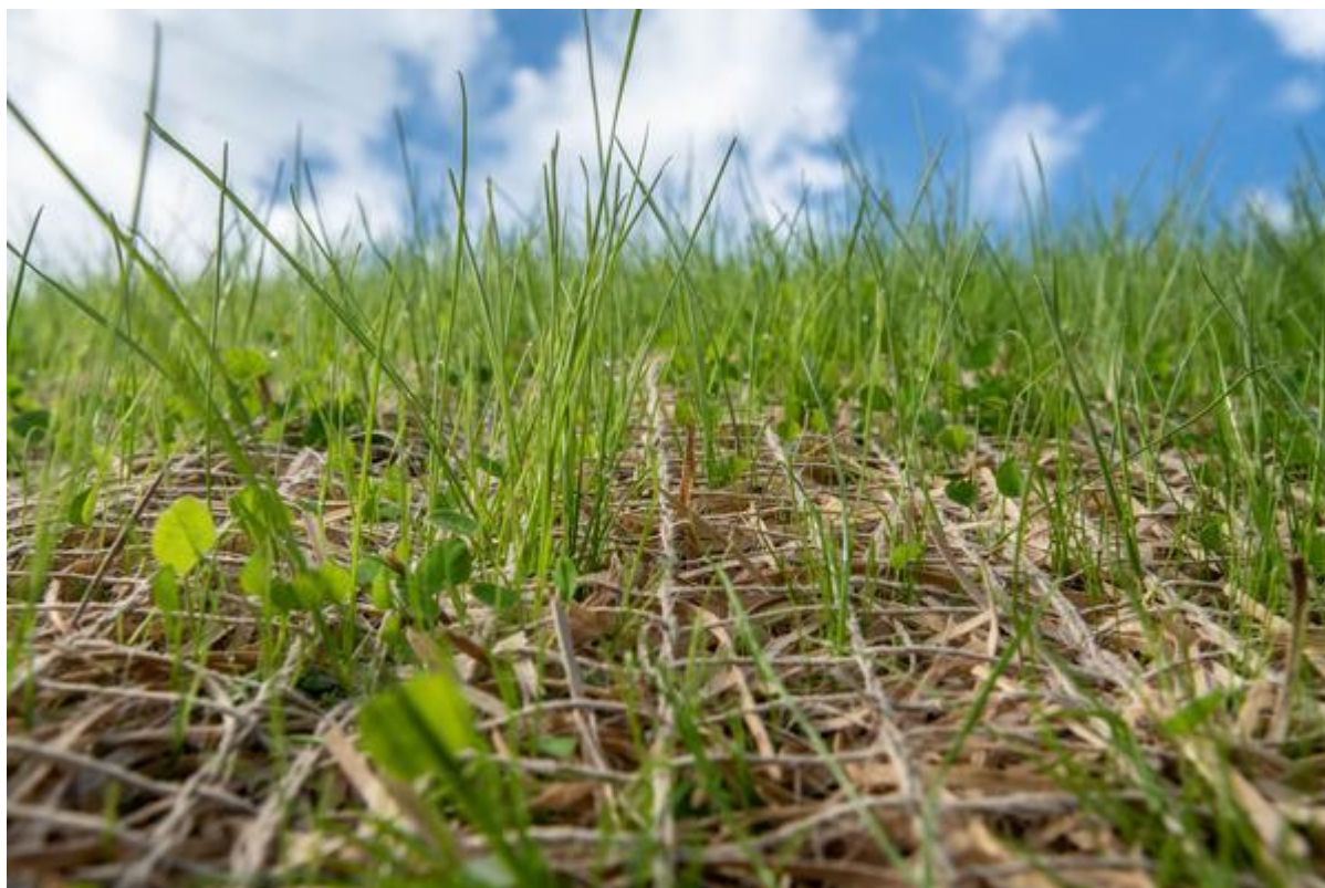
Fig. 1 - Consolidamento di una scarpata tramite una stuoia realizzata con lana di legno. La vegetazione inizia a crescere.
