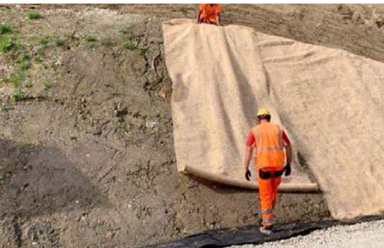
Abb 4: Verlegen der Erosionsschutzvliese an einer Böschung. Fig. 4 : Pose d'une natte de protection contre l'érosion sur un talus.
