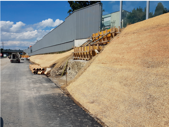
Abb. 6: Frisch verlegte Howolis-Erosionsschutzvliese an den neuen Böschungen der Schnellstraße K10 im Kanton Zürich, 13. Juli 2017, kurz vor der Ansaat mit autochthonem (lokalem) Saatgut.
