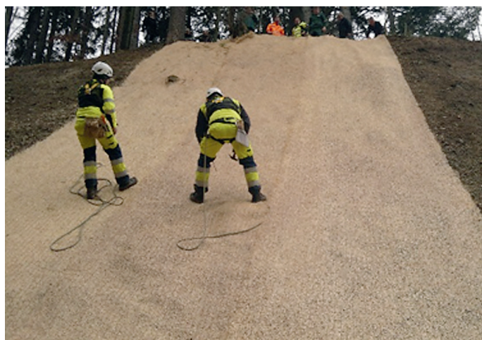
Abb. 5: Vernagelung der Matten am Hang Fig. 5: Fixation of the matts on slope
