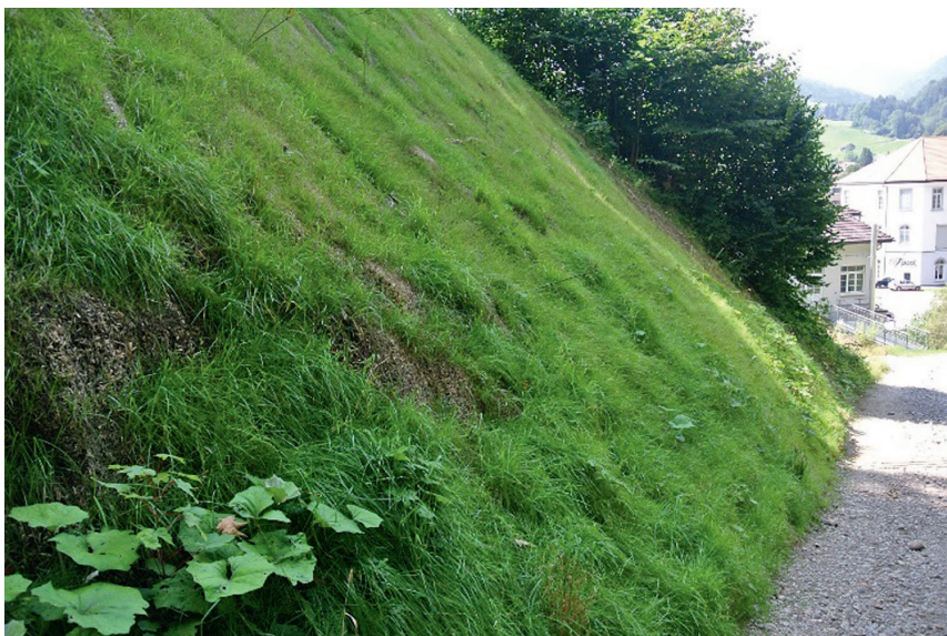
Abb. 12: Versuchsfläche ein Jahr nach Installation Fig. 12: Testing area one year after installation
